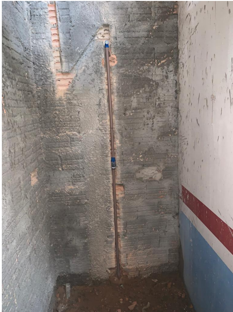
Figura 43 - Tubulação de água interna a parede.
