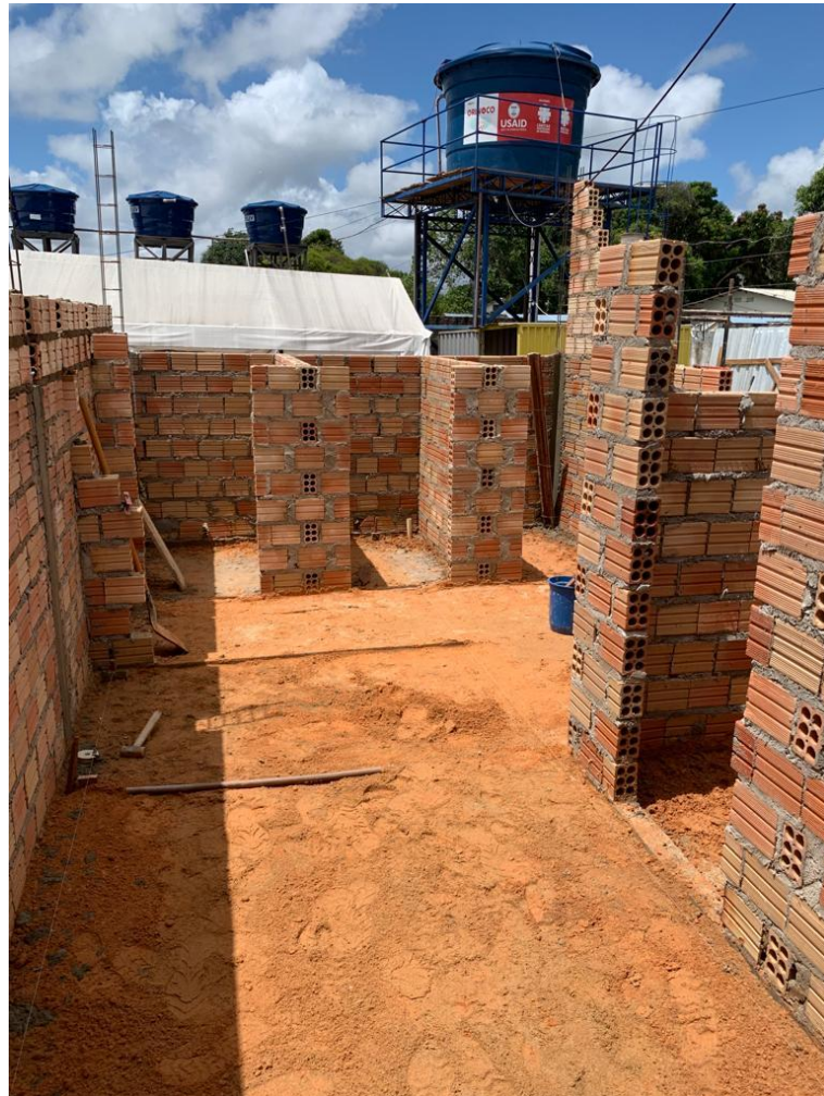
Figura 14 - Área interna aterrada e paredes.
